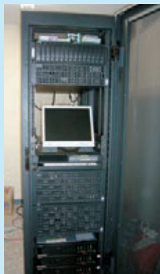
電子カルテサーバ室
