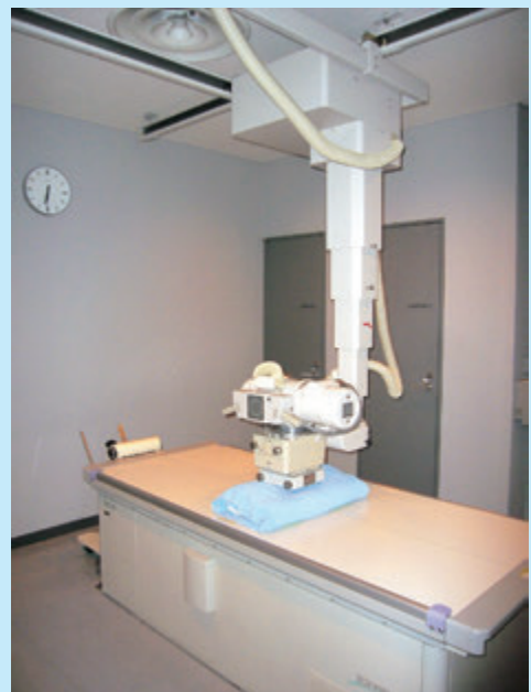
X線検査室：天井走行型X線装置
