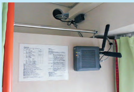
検診車内に設置されたゲートウェイ機器
